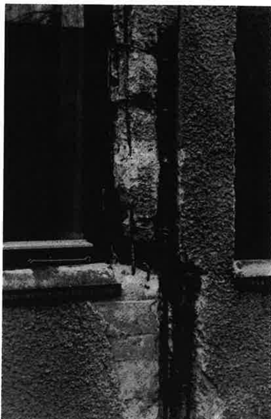
For liten armeringsoverdekning øker faren for armeringskorrosjon med resultat som vist.
